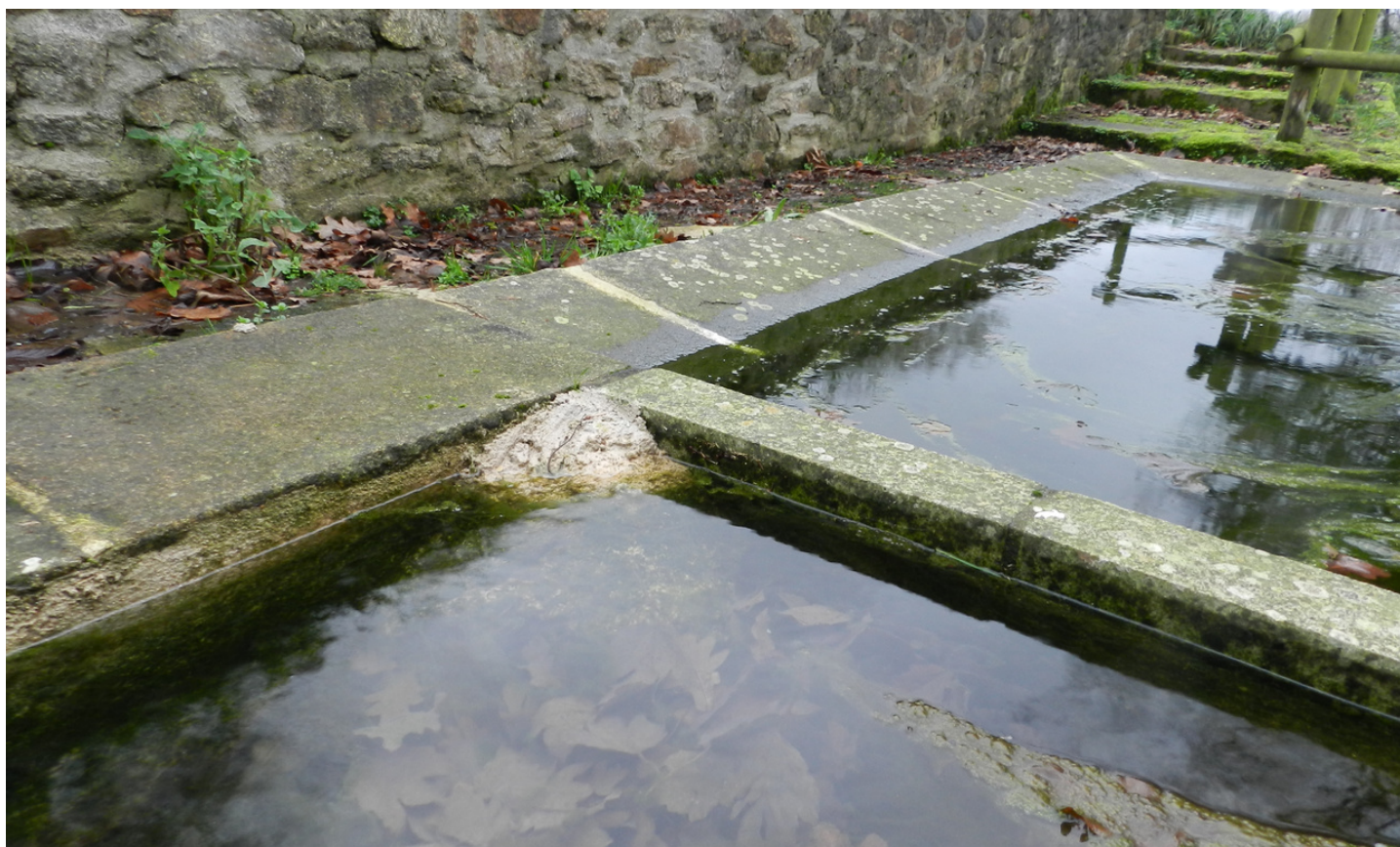
Rampe conique maçonnée facilitant la sortie de la faune © Lavoires et fontaines à Plaintel
