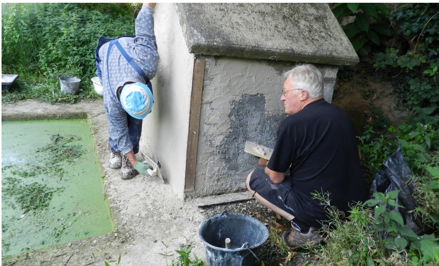
Recours à un mortier sable - chaux à l'extérieur du lavoir © Lavoirs et fontaines à Plaintel
