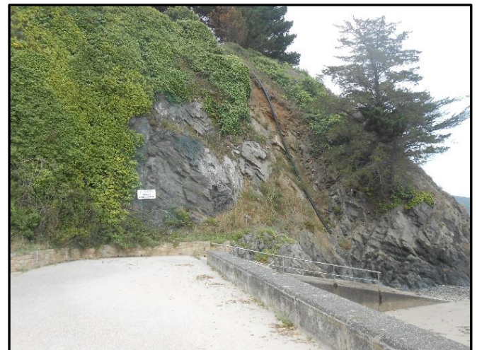
Fig. 89: Erosion de la falaise et mesures de protection contre les éboulements
