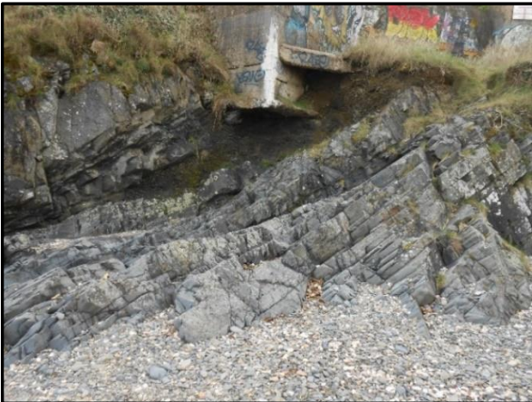
Fig.16 : Erosion de la falaise sous le blockhaus
