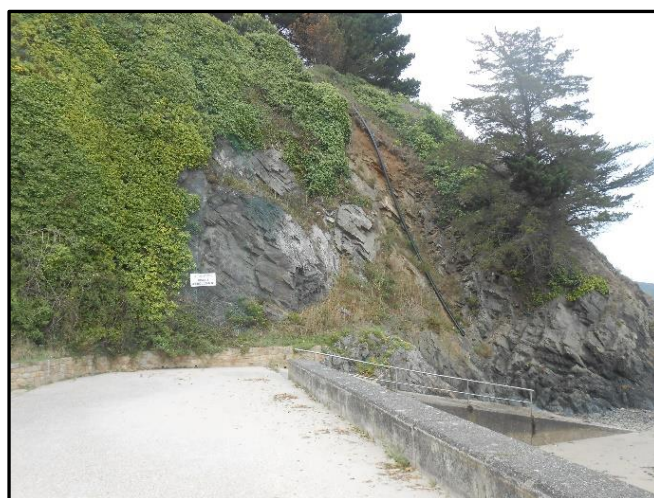
Fig. 89: Erosion de la falaise et mesures de protection contre les éboulements
