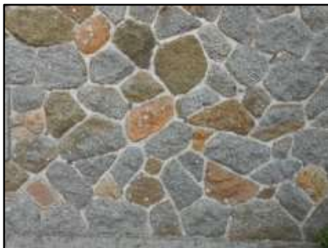
Fig.8 : Grès éocène sur le mur de l'église de Cesson (3)
