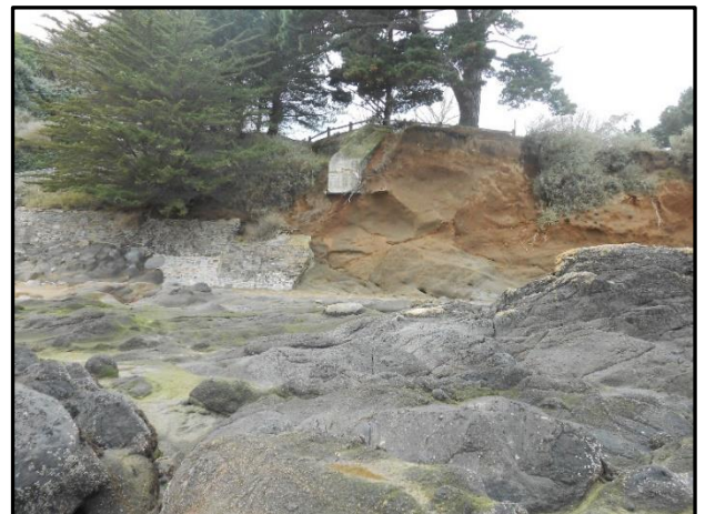
Fig.92 : Erosion de la diorite sous le blockhaus
